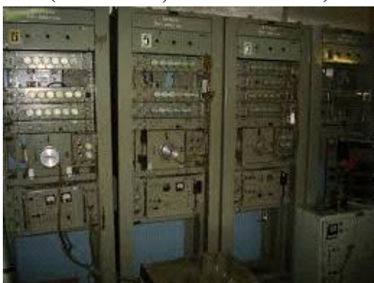
Радиорелейная станция Р-600
