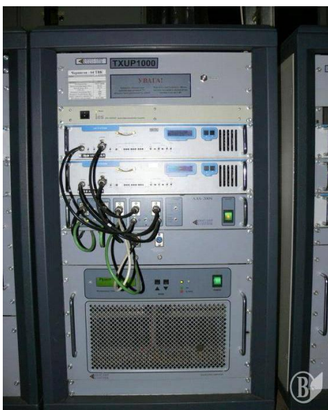
Транзисторный ТВ передатчик ТХУР1000 ( P = 1 \text{ кВт} )
